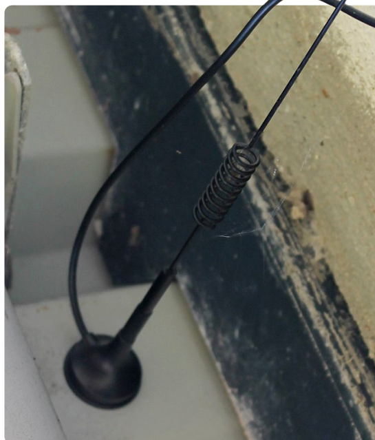
Figuur 4: De antenne van de ontvanger gemonteerd op het metalen dak van de schuur.
